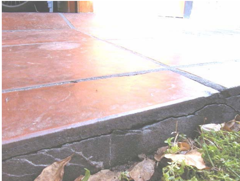
Figura 5. Rotura del cordón perimetral por expansión del piso
