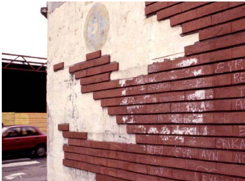
Figura 8. Desprendimientos sobre una pared pintada
